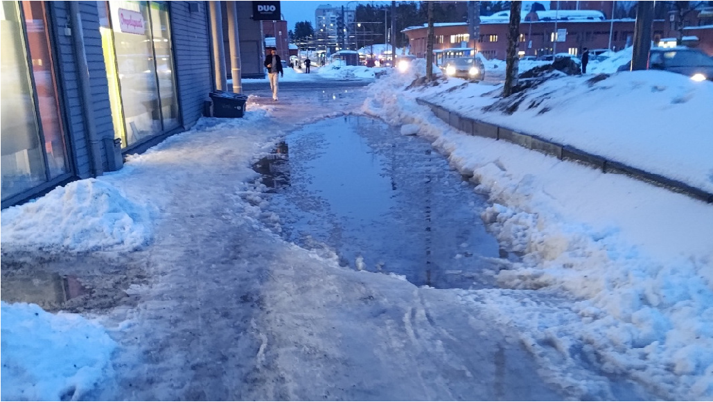
Kuva 7 Insinöörinkatu 19 kohdalla on varsin samankaltainen ratkaisu jossa jalkakäytävä ja pyörätie on tukimuurin alapuolella ajorataa alemmassa tasossa ja kuivatuksen on ajateltu tapahtuvan yhden kaivon kautta
